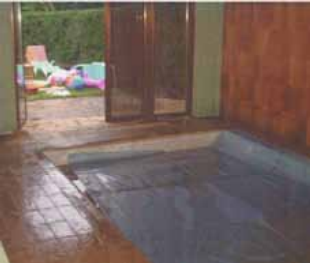
ein kaputtes Schwimmbecken
