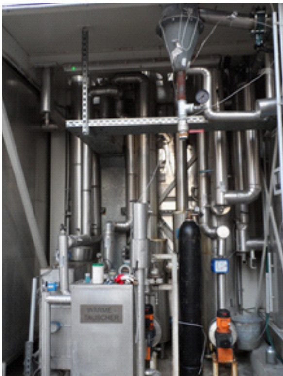
Abb 4: Pilotanlage CO 2 Wäsche
